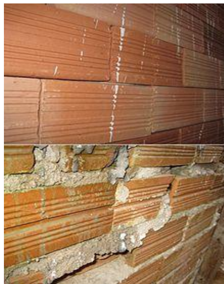
Figura 3: Diferença no assentamento.
