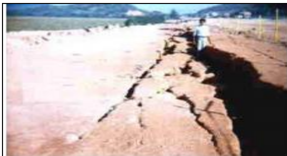
Fig. 18 – Ruptura em aterro
