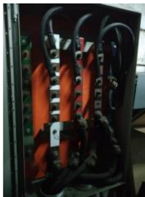
Figura 7: Cabos ligados diretamente ao barramento e falta de proteção Fonte: Autores (2020)
