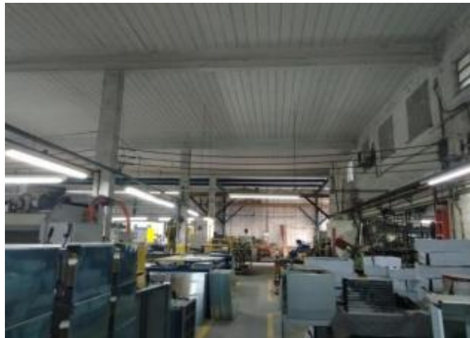
Figura 8: Área de produção com cabos expostos Fonte: Autores (2020)
