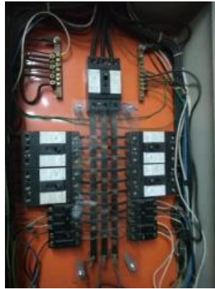
Figura 6: Painel sem identificação e caos sem proteção Fonte: Autores (2020)
