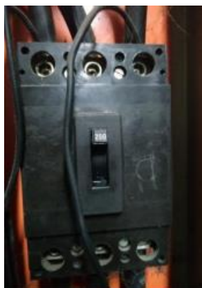
Figura 5: Instalação incorreta no disjuntor Fonte: Autores (2020)
